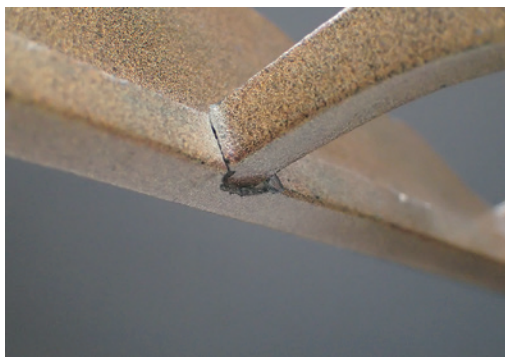
図7 見台B 格子部の亀裂 修理前
