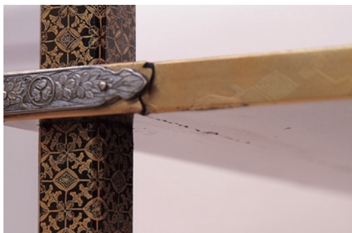
図14 胡蝶書棚 右一段目の棚板裏 亀裂と塗膜剥離 修理後
